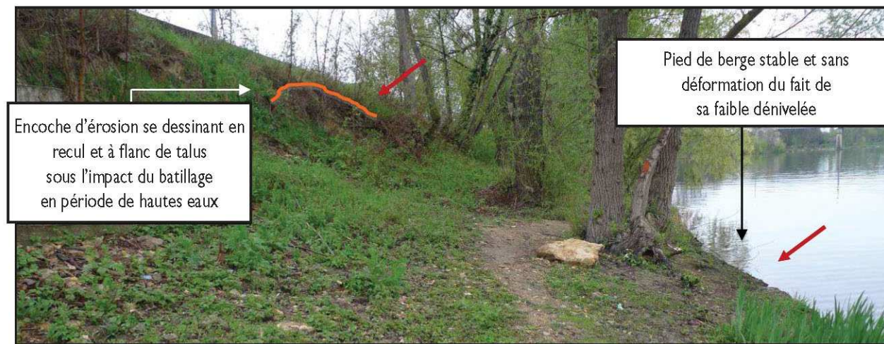
Photo 3 - Illustration du léger phénomène d'érosion en recul de la ligne de pied de rive sur le tronçon aval (Source : BIOTEC)
